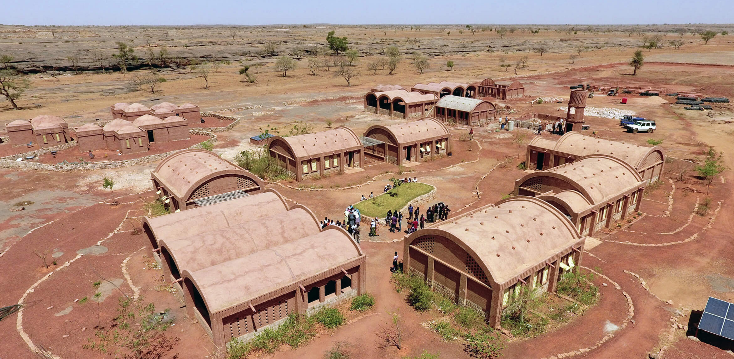
Collège de formation pratique Sangha, construction du deuxième groupe, 2018, Photo de LEVS architecten
